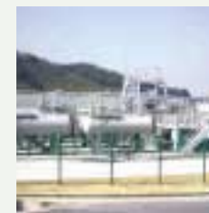
▲ 올레핀 정제설비 (Olefin Purification Apparatus) ◀ 고순도 이소부탄 생산 설비 (High Purity Iso-Butane Production Plant)
