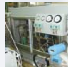
▲ 지중열교환기 (Ground Loop) ◀ 캐스케이드 히트펌프 (Cascade Heat Pump)
